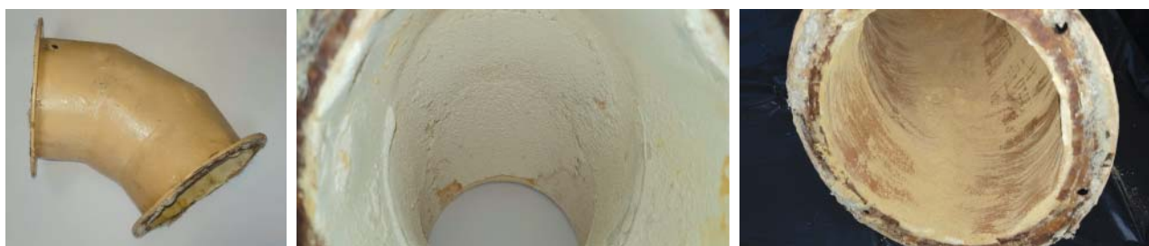
Рис. 1. Процесс очистки перегиба трубопровода системы местных отсосов оборудования по обработке полимерных материалов АО «Концерн «Созвездие»» (отвод 45°, D190)
